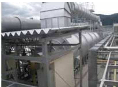
灯油から天然ガスに燃料転換し CO 2 排出量を削減した脱臭炉
